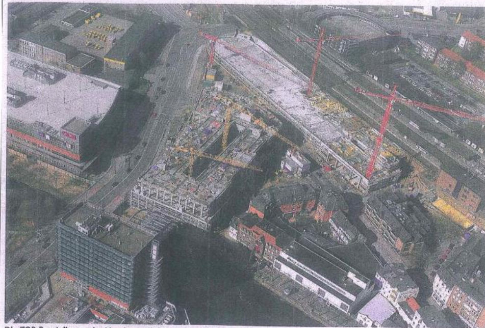
Die ZOB-Baustelle aus der Vogelperspektive: Insgesamt vier Kräne stehen mitten in den Gebäuden. Die beiden gelben werden in diesem Monat aus dem CCB-Neubau (M.) gezogen. Die roten bleiben im künftigen ZOB (re.) noch wenigstens bis Mai. Foto: Weltzel
