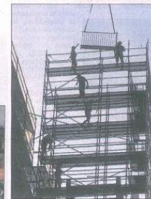
Blick hinauf: In mehr als 50 Metern Höhe über dem Serrah montieren Stahlbauer das neue Außentreppehaus am Wohnturm über dem Einkaufszentrum CCB. Foto: Handsche
