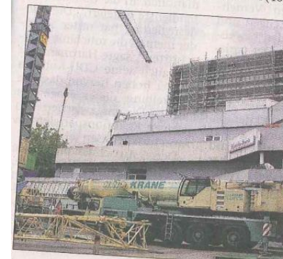
Der Mobilkran ist vor dem CCB eingetroffen. Vom heutigen Sonnabend an soll mit seiner Hilfe das Fluchttreppenhaus an dem Wohnturm montiert werden. Foto: Meyer
